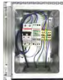
Esempio centralina di controllo interna
